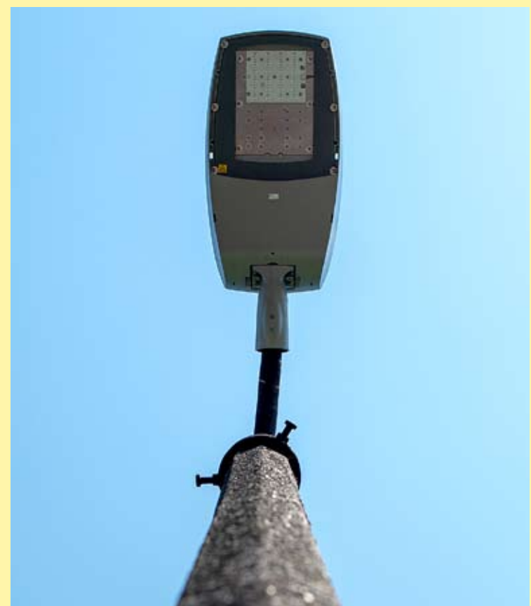
Na kolejnych ulicach stare oprawy sodowe są wymieniane na LED-owe – nowoczesne i energooszczędne.
